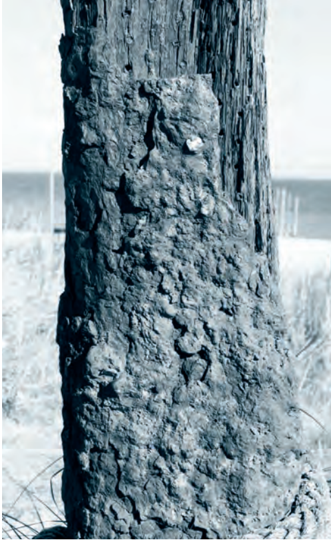
Afb. 6. Paal met roestpanter van gecorrodeerde wormspijkers bij De Cocksdorp (Texel). De paal is afkomstig uit oude havenwerken van Monnickendam. Foto Michiel H. Bartels, Archeologie West-Friesland, Hoorn.
